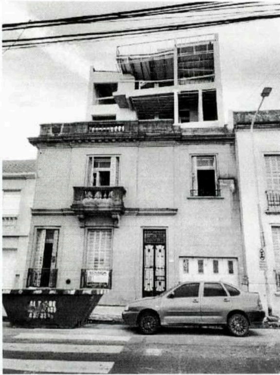
Falta de cartelera que indique responsabilidad, tiempo y objetivo de la obra.
