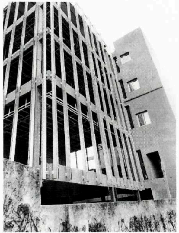
Ocupación indebida de medianera y falta de resguardo de normas de seguridad
